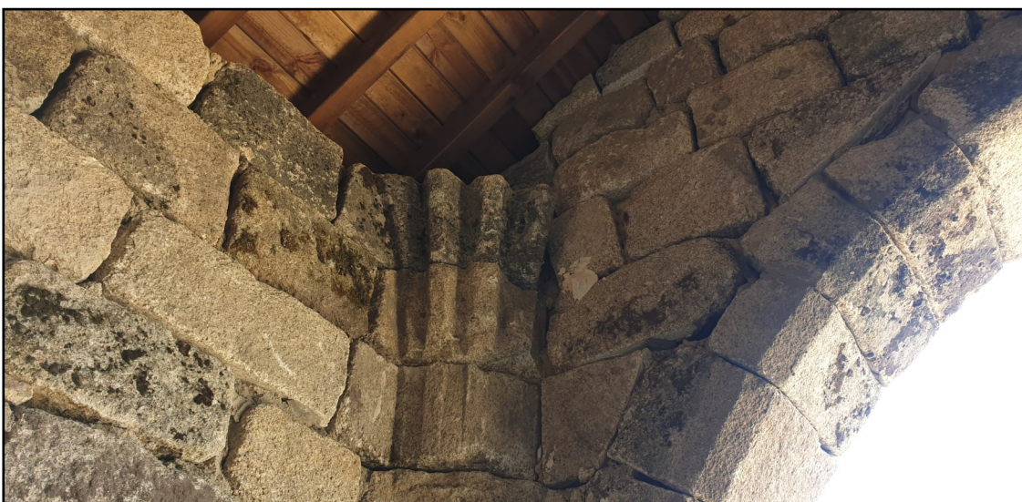
Imagen 19: Restos de los arranques de la bóveda
